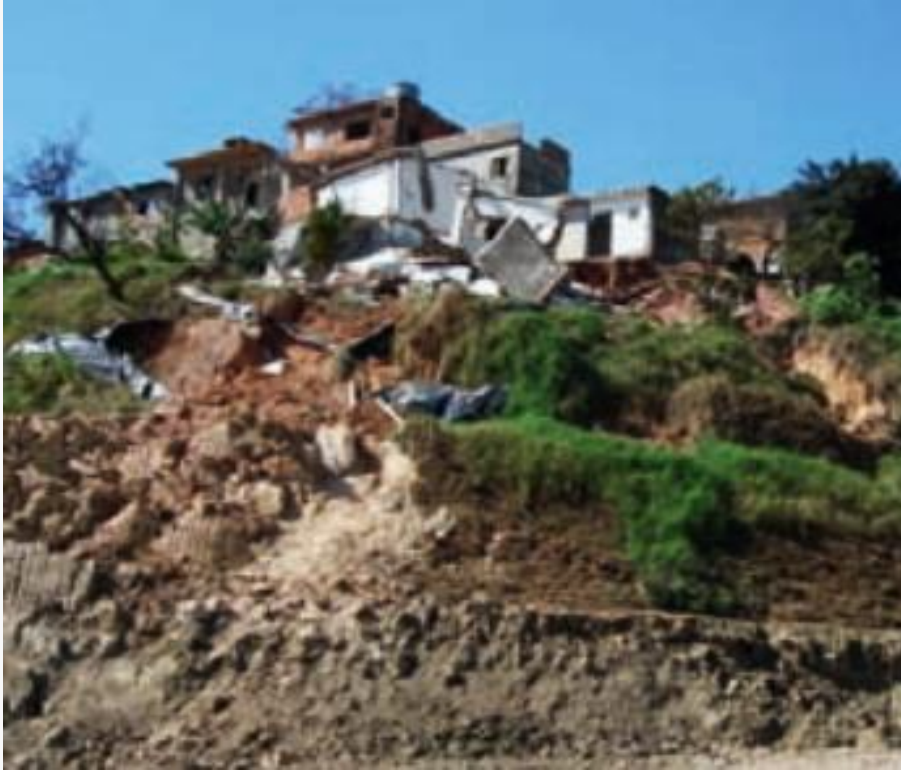
Escorregamento em talude de corte, Jandira, SP (Tominaga et al., 2018)
